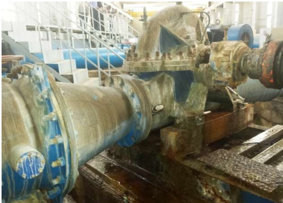
Instalación industrial deteriorada Problemas graves de corrosión y fugas activas de fluidos.
