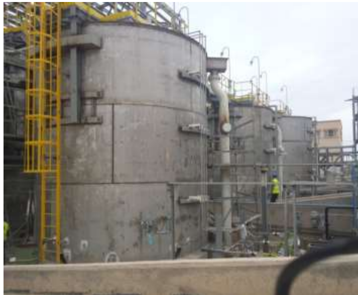
Detalle de los depósitos para lavado de fosfato
