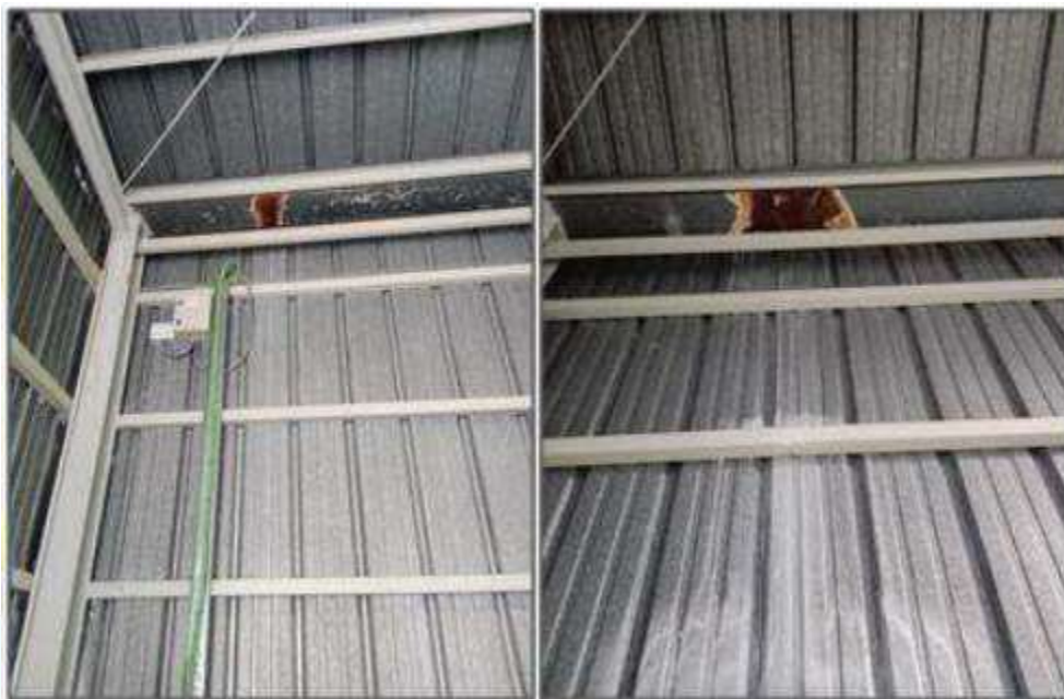
Detalle de la corrosión de los canalones y la pérdida de sección que provocaba filtraciones.
