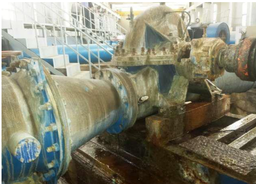
Installation industrielle détérioré Graves problèmes de corrosion et fuites des fluides
