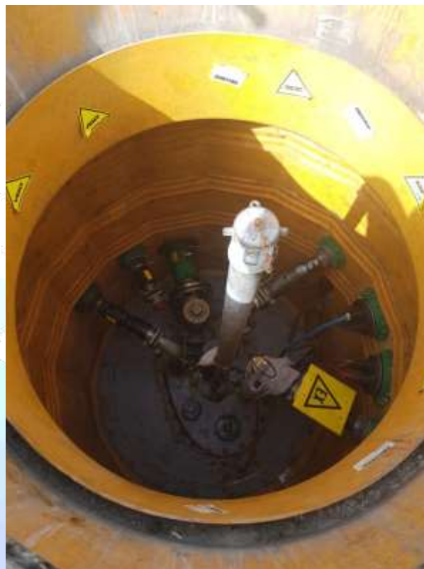
Bassin collecteur avant traitement avec STM .
